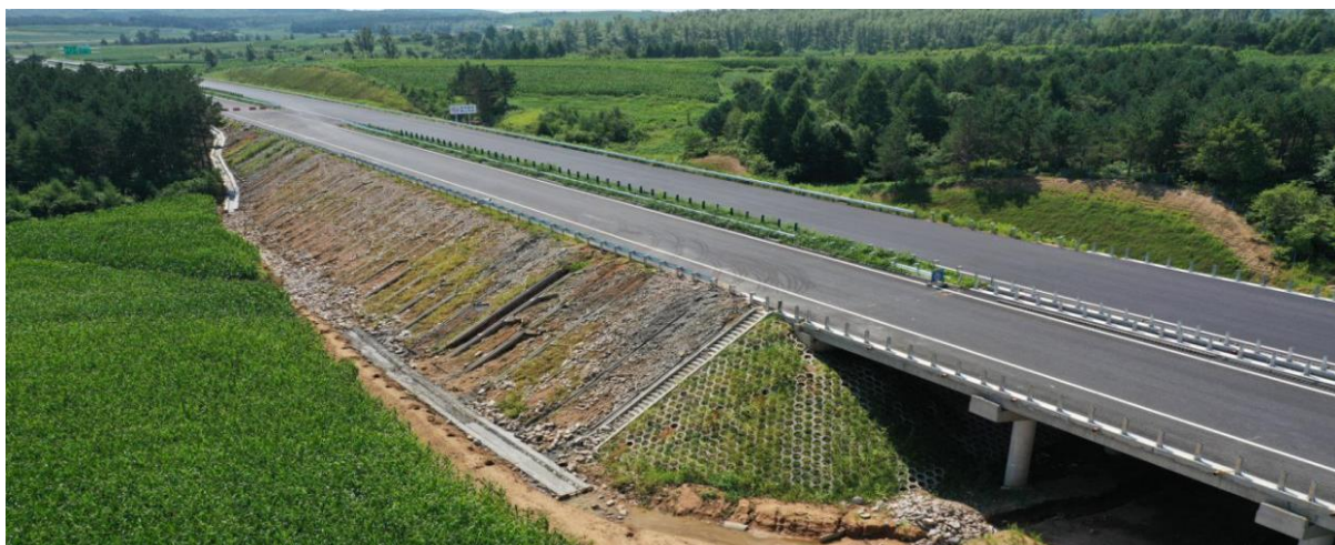
填方边坡上存在建筑垃圾
