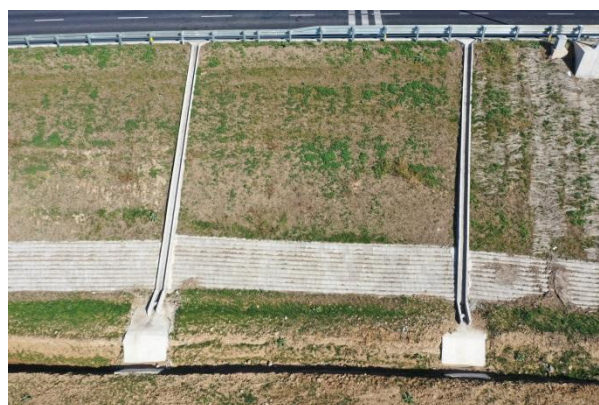
植草护坡+急流槽+土沟（2019 年 9 月）
